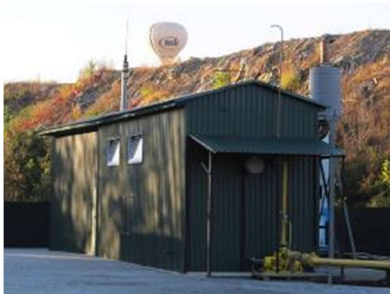
Електростанція на звалищному газі потужністю 0,6 МВт (м. Кам'янець-Подільський).
