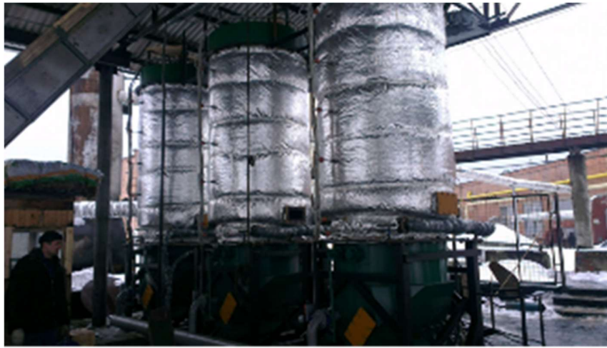
Газогенератор періодичної дії потужністю 2 МВт (м. Малин).
