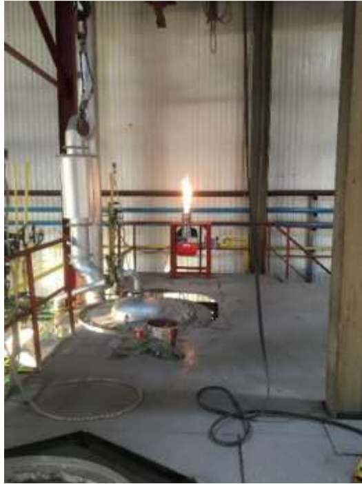
Рис. 1.7 - Блочний пальник, що працює на синтез-газі. Пальник SIB Unigas, будівництво заводу перероблення полімерів та відходів мастил – за участю Інституту газу НАН України
